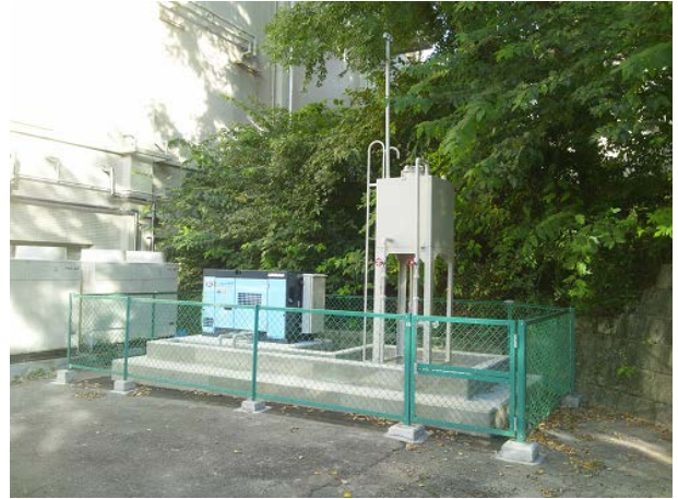
図1. 自家発電システムの自家発電機部分
