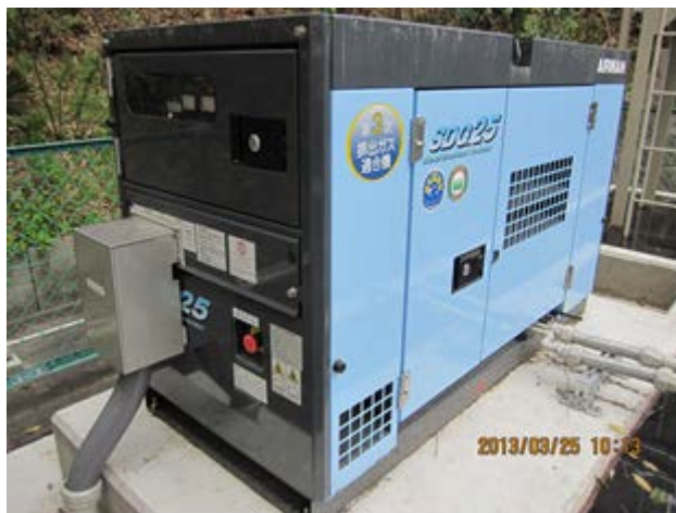
図3. 自家発電機外観
